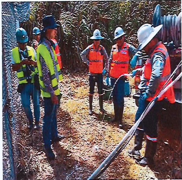
Foto 4 Purga de agua de pozo.
